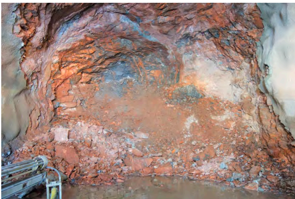
Figur 1. Rödomvandling i tunneldel km 0/367 i ramptunnel 411.
